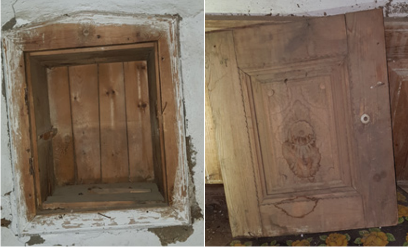
Foto 32: Oda iç mekân batı cephesindeki gömme dolap ve yere düşen kapağı
