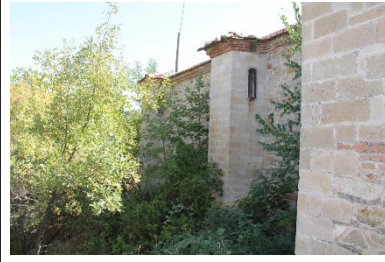
Fotoğraf 22: Güney bina havalandırma bacaları.
