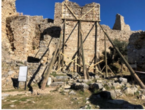
Fotoğraf 18: Kale girişinde çökme tehlikesine karşı desteklenen burç duvarları
