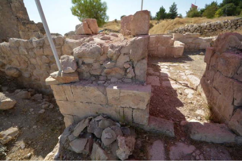
Duvarların Restorasyon Öncesi Durumu
